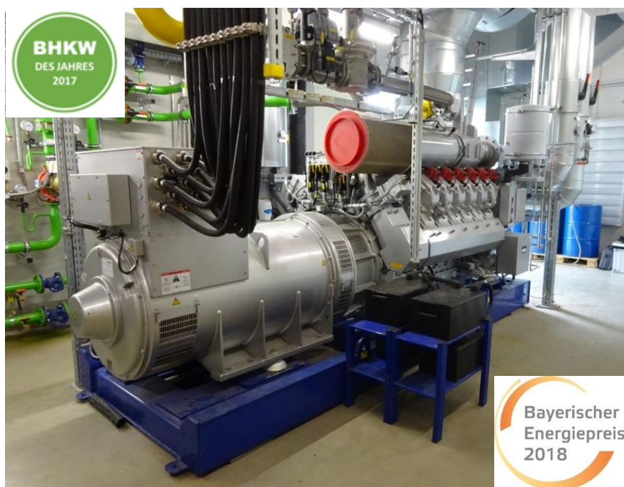
Abbildung 5: Erdgas-BHKW als KWKK-Verbund am Standort in Kernath
